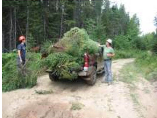
Figure 5 : Chargement des cimes d'épinettes noires, des sapins baumier et des piquets de bois utilisés pour les travaux de restauration au ruisseau Sewell.
