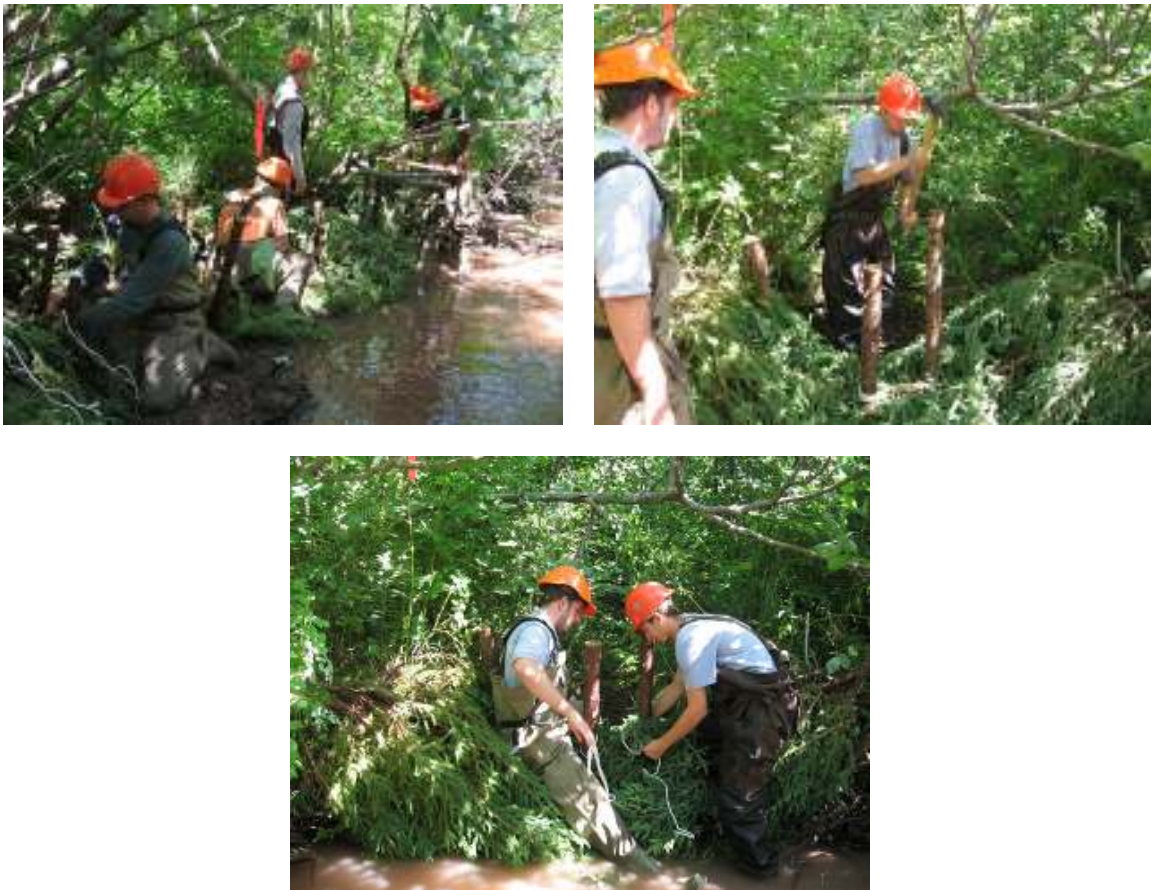
Figure 7 : Réparation des berges érodées par la mise en place des murs de soutient au ruisseau Sewell.
