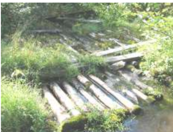
Figure 4. Pont effondré traversant le ruisseau McConnell.
