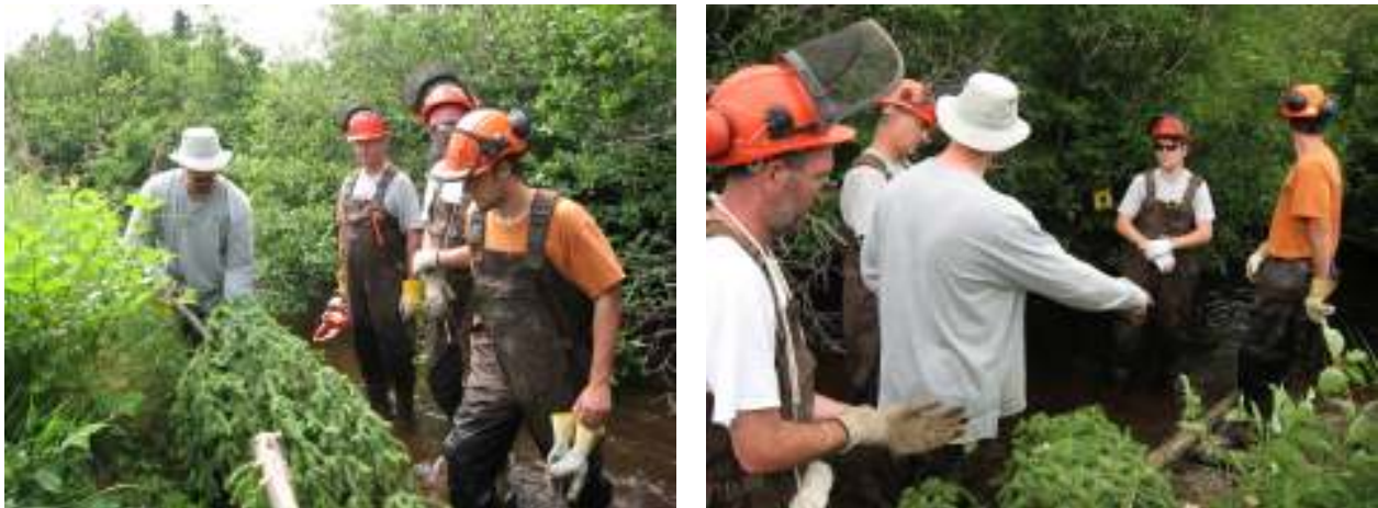
Figure 18 : Explications de la méthode d'installation des déflecteurs au ruisseau McConnell, par Terry Melanson, de Pêches et Océans Canada.
