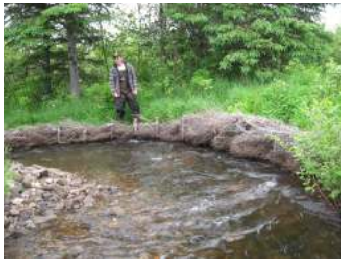
Figure 16 : Berge érodée au ruisseau McConnell avant les réparations de 2008.
