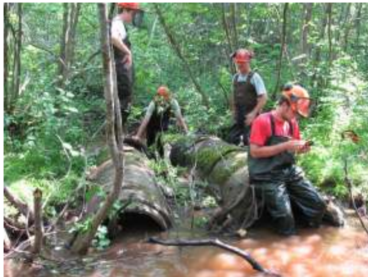
Figure 9 : ancien ponceau avec tuyau de ciment freinant le débit d'eau du ruisseau.
