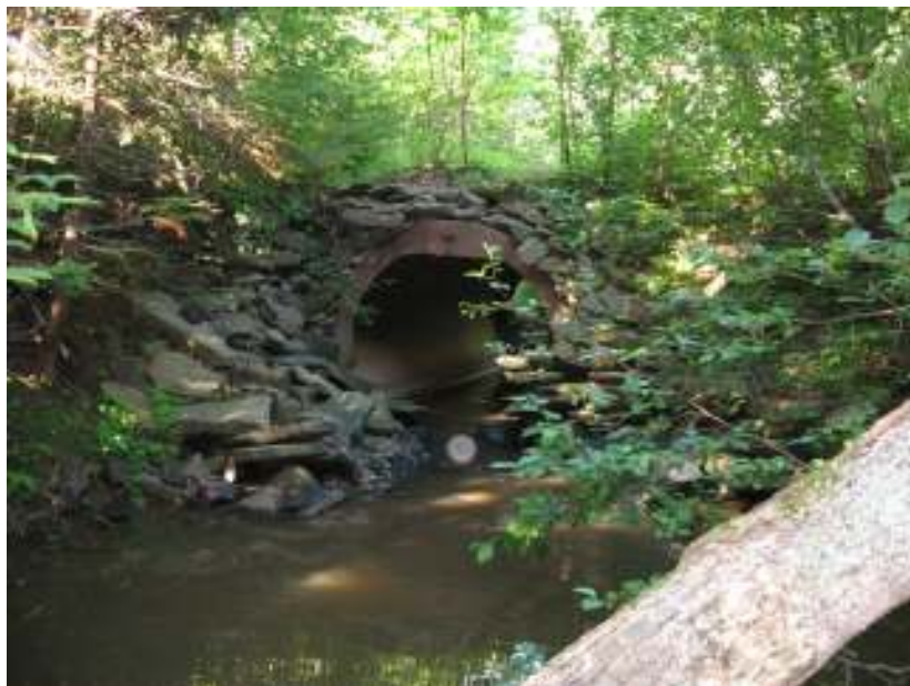
Figure 8 : Blocage causé par un amas de roches tombés dans le ruisseau.
